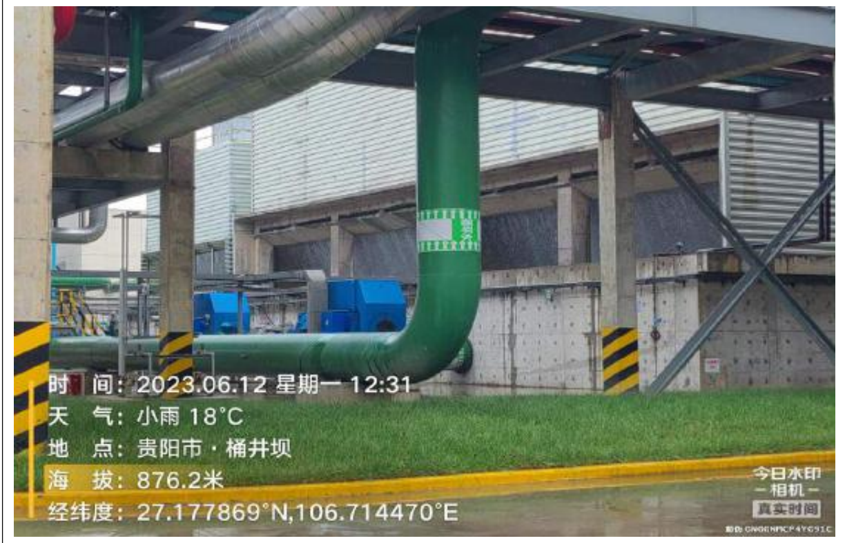
循环水站现场照片
