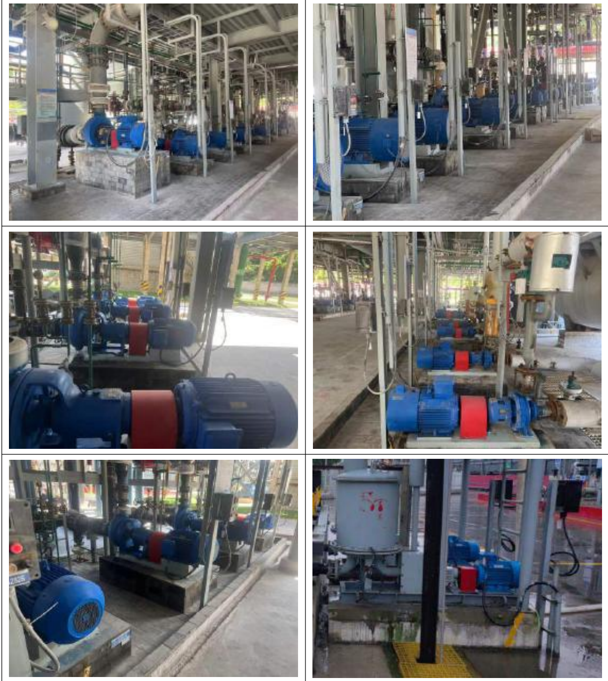
传输泵现场照片
